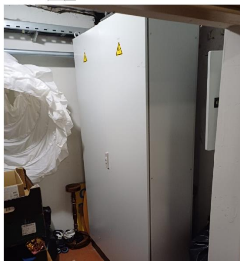
14. att. Līkās ielas 21 galvenā elektrosadales telpa
