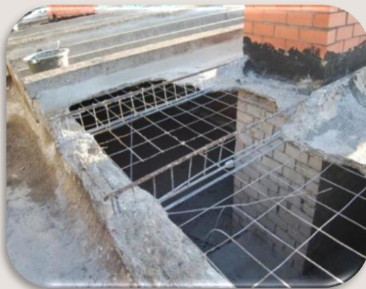
Bojāta jumta konstrukcija
